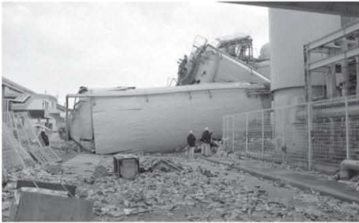
倒壊した4基のブライトンピアタンク
